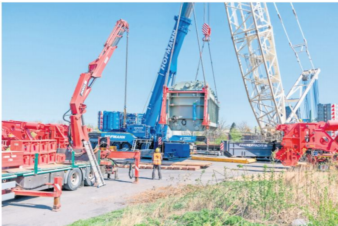
Der 290 Tonnen schwere Trafo hängt am Haken zweier Krane und wird nun auf den Schwertransporter umgeladen.
